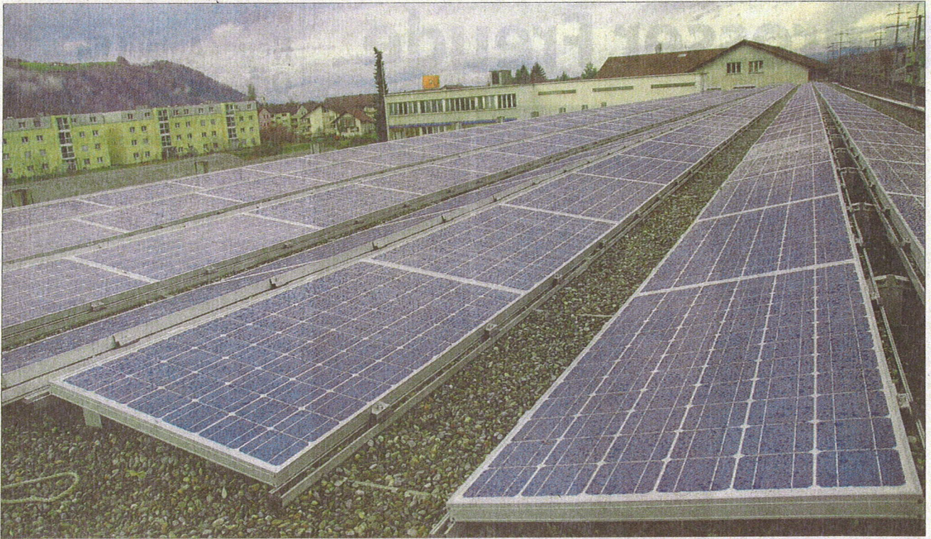
494 Solarmodule produzieren seit letzter Woche Strom aus Sonnenkraft. (Bild: sl)
