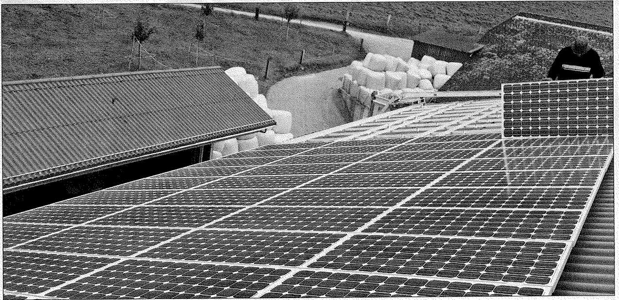
Die Solarpanels auf dem Scheunendach bedecken eine Fläche von rund 210 m 2 .
